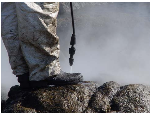
Foto 5. Observese a excesiva proximidade do chorro á rocha
