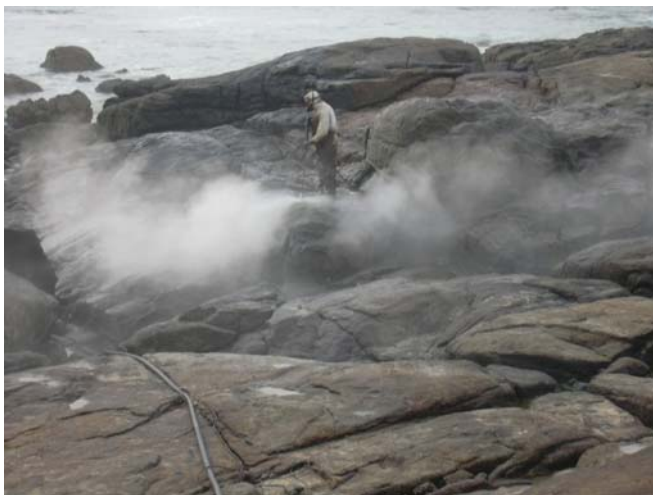
Foto 2. Emprego de auga quente en Punta de Barca. Obsérvese a ausencia de mantas hidrófugas.
