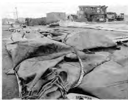
La fuerza del mar destruyó los protectores situados a la entrada del puerto de Camariñas
